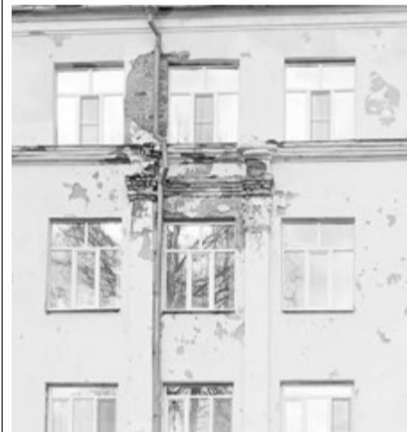
Школа №29: разрушенный фасад
